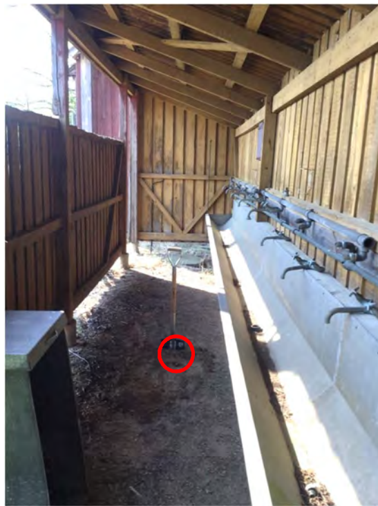
Figur 6. ND, B, 7, 4. Grusad yta i tvättrummet
